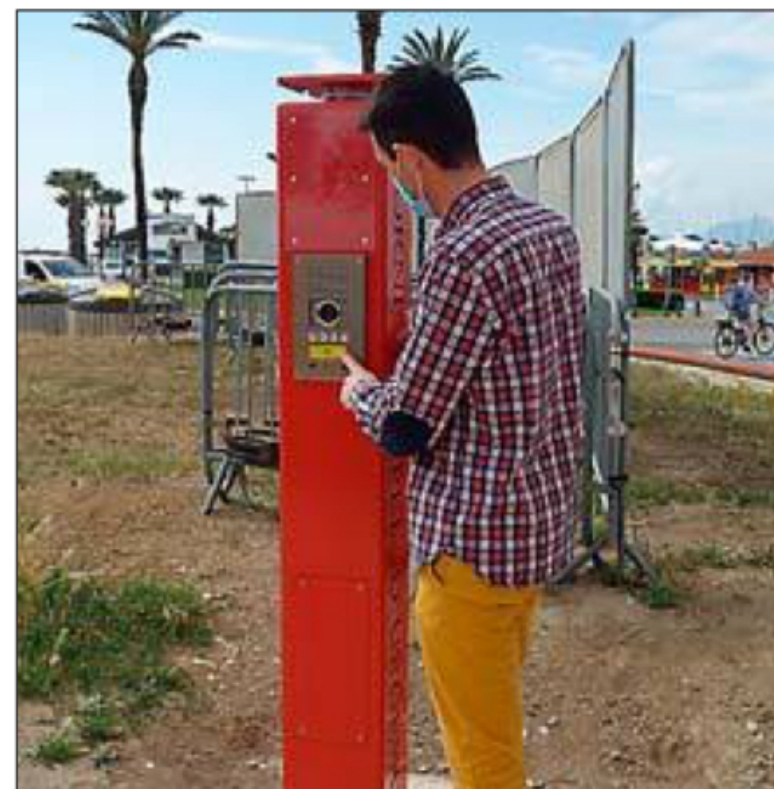
► La première borne vient d'être installée devant la Maison des associations.
